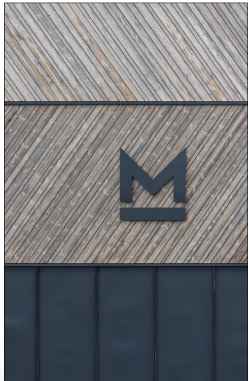
Hölzerne Außen- und schwarze Metallfassade geben das Material- und Farbkonzept vor. (Foto: © Haslob Kruse + Partner Architekten, Bremen)
