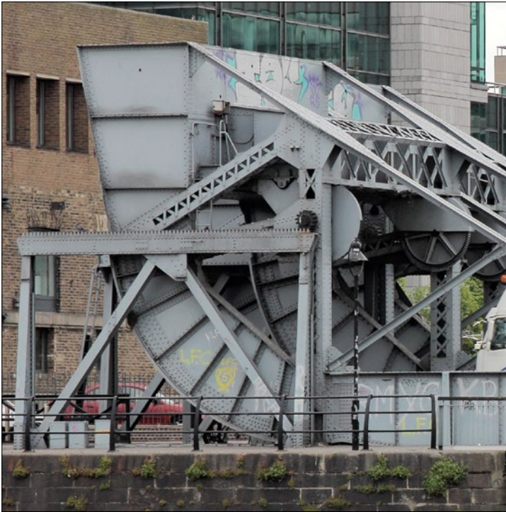
Die beiden Dock Bridges stehen leicht versetzt hintereinander. Die Zahnstangen befinden sich bei Rollklappbrücken etwa auf halber Höhe. Der schwarz lackierte Drehpunkt wird beim Öffnen der Brücke nach hinten verschoben (2017). (Foto: Helmut Seger)
