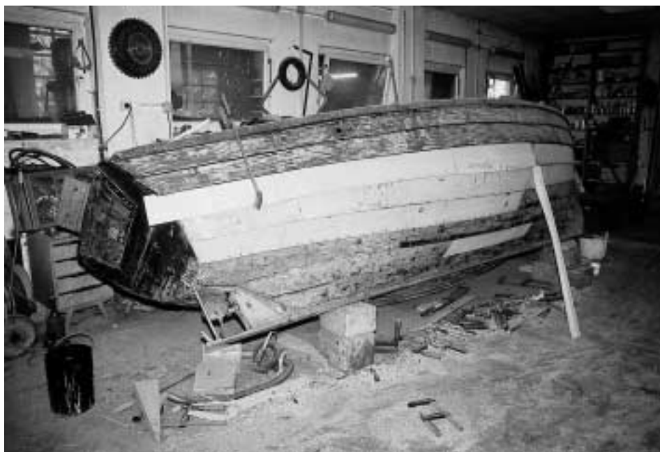
Abb. 4 Plankenwechsel an einem Motorboot, das 2004 auf der Bootswerft Lorenz in Middelhagen wieder für die Fischerei zurückgebaut wird.
