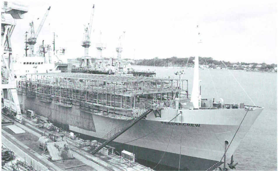
Umbau des MS FEEDERCREW zu einem Livestock Carrier im Standort Rostock, der ehemaligen Neptunwerft. Foto: Gudrun Bär
